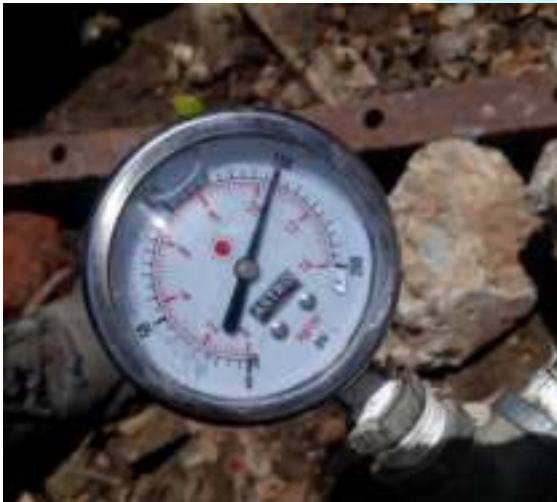
Manómetro mostrando la presión obtenida en la prueba hidráulica de la tubería.
